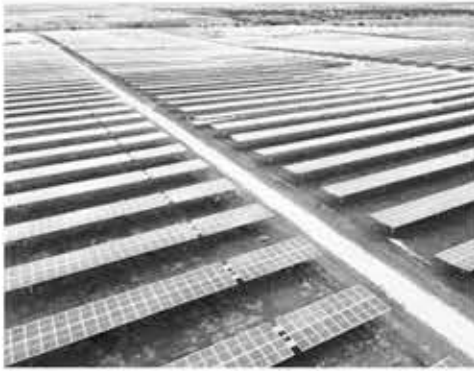
▲ 한화큐셀 미국 텍사스주 168MW급 태양광 발전소 모습 사진=한화큐셀
